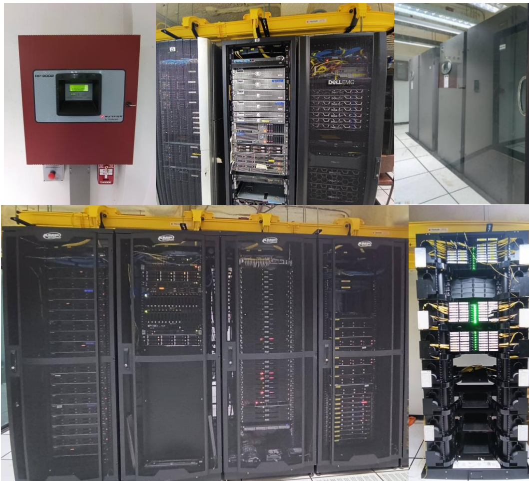
ภาพประกอบ ห้องศูนย์ข้อมูล (Data Center) ที่ให้บริการ 24 ชั่วโมง
